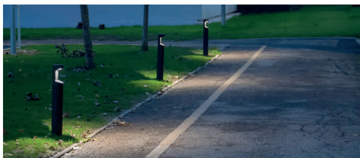
Réhabilitation de circulations extérieures à Chelles (77) avec des bornes Bolarside conçues pour obtenir 20 lux moyens le long d'un cheminement sans perte de flux.
